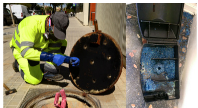
Figura 2. Instalación de cebos rodenticidas anticoagulantes en un registro de alcantarillado y estación portacebos de superficie, respectivamente. Fuente: Lokímica SA.
